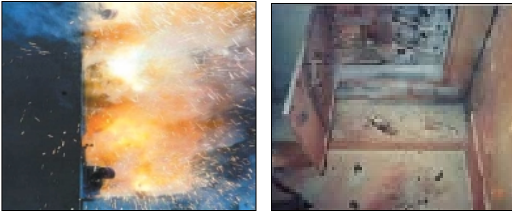
Figura No.2. Arc Flash en panel. 3
